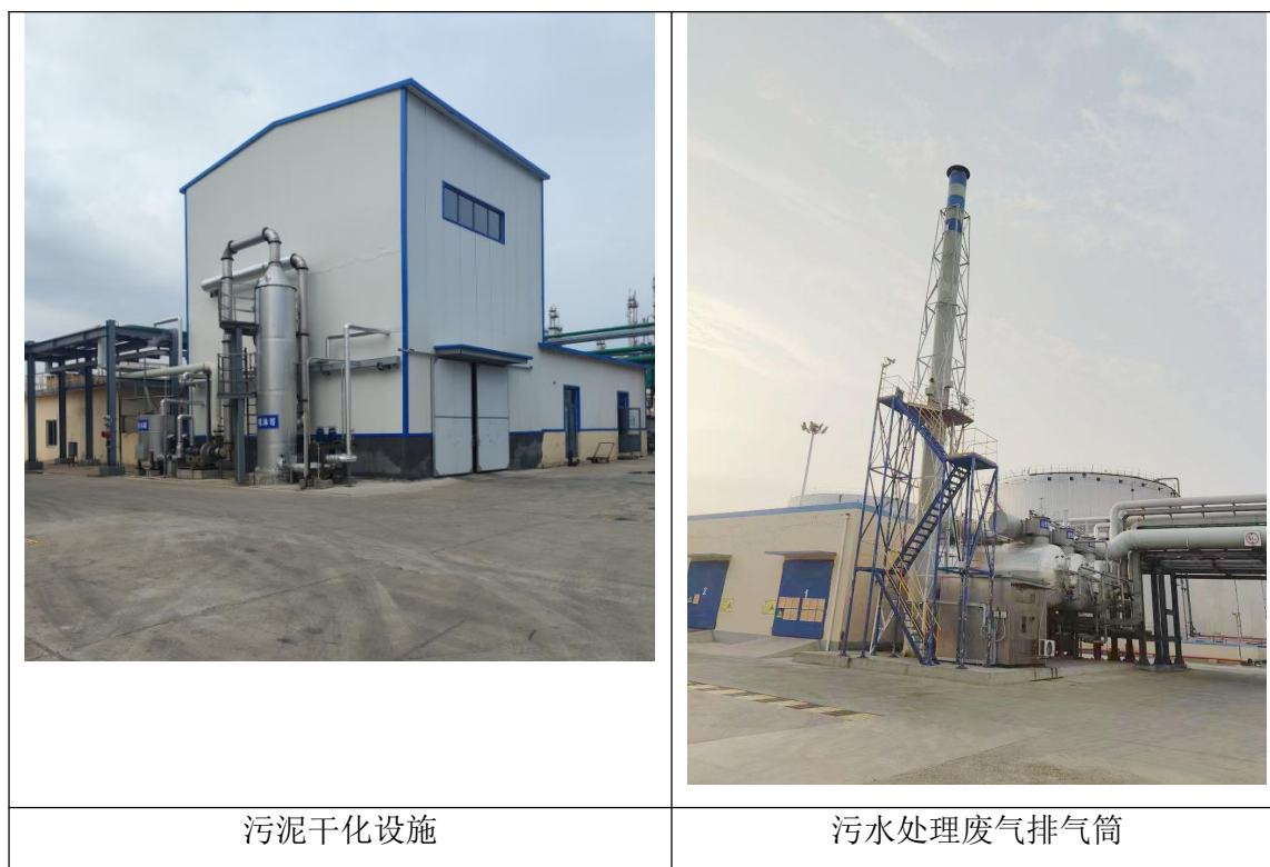
图4.1-2 本项目废气治理设施
